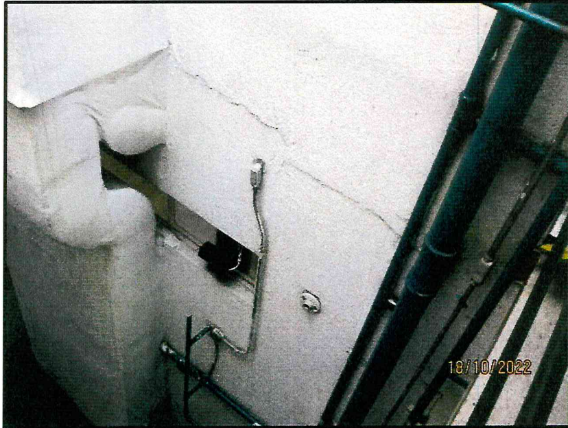
Foto 13. Fisuramiento de recubrimiento en zona de servicios, forma continua con la trabe existente
