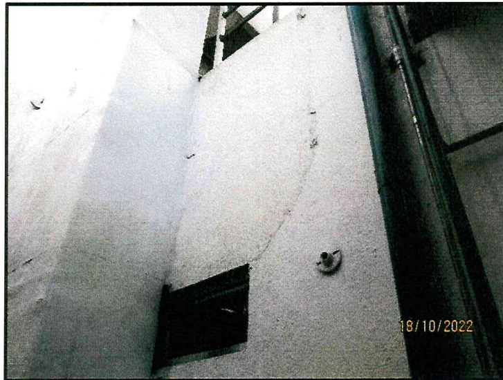
Foto 14. Fisuramiento de recubrimiento en zona de servicios.
